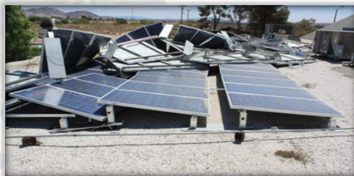
Fig. 3. Deteriorarea generatorului fotovoltaic sub influența vântului
