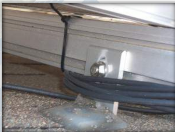
Fig. 5. Cablurile fotovoltaice aranjate incorect fără traseu de cablu
