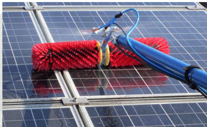
Εικόνα 8. Πλύσιμο της εγκατάστασης φωτοβολταϊκών
